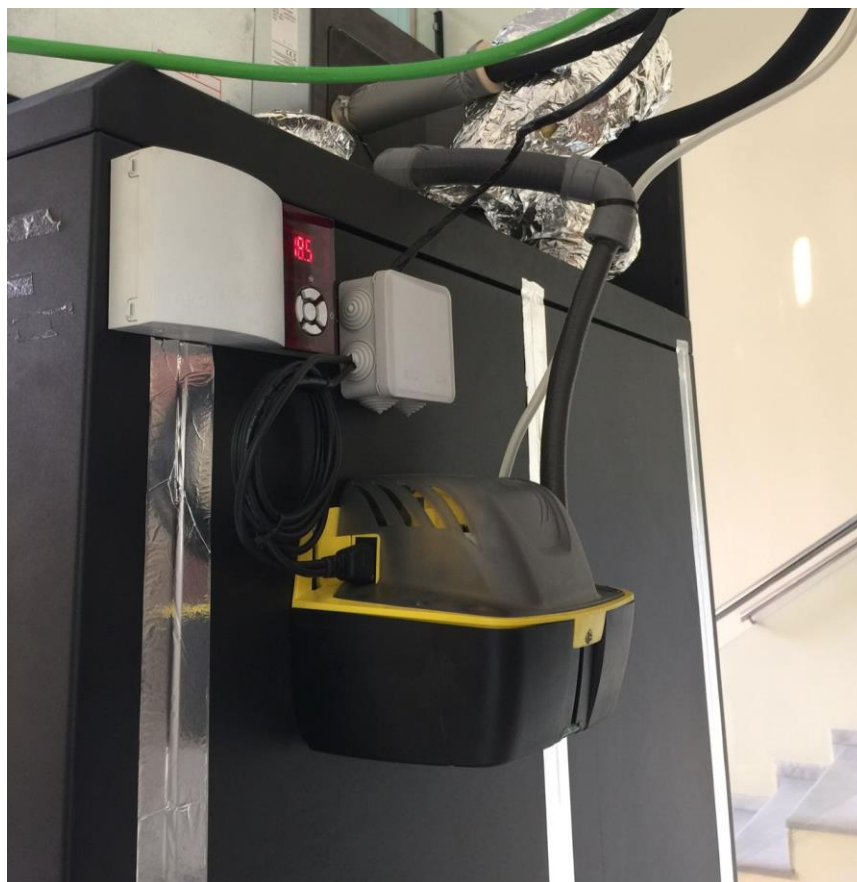
4.21 Bomba de agua del AC principal
